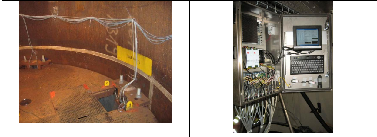
Figure III- 49: Réseau filaire de capteurs de corrosion dans les fondations d'une éolienne offshore
